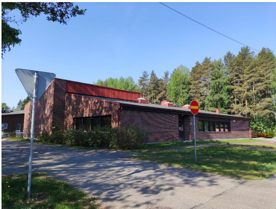
Kuva: Huonokuntoinen Kattilasillan nuorisotalo on tarkoitus purkaa lähivuosina.
